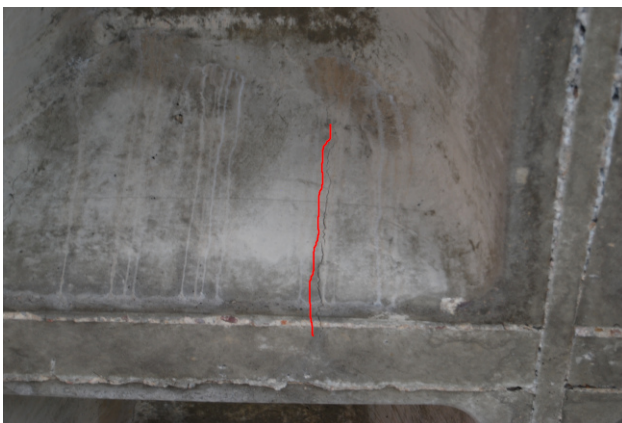
(a) Fisuras observadas en el forjado de planta cubierta, en el encuentro de los nervios del reticular con los ábacos de menor longitud en el sentido de la luz principal
