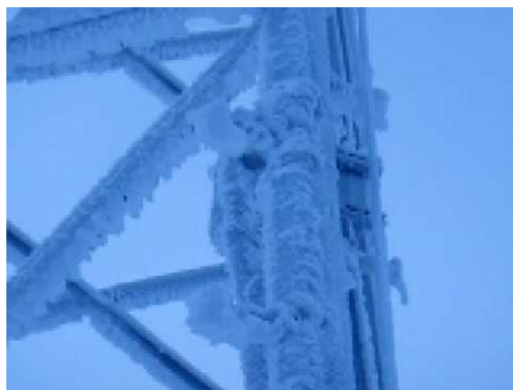
Figura 3: Hielo adherido a las barras de una torre en celosía.
