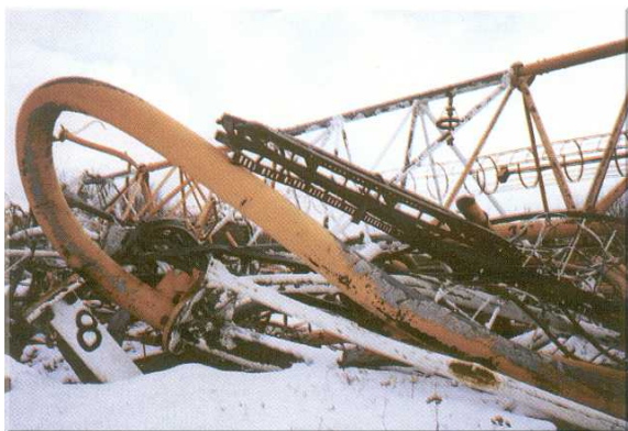
Figura 1: Colapso del mástil de 646.38 metros de altura de radio Varsovia (1991).
